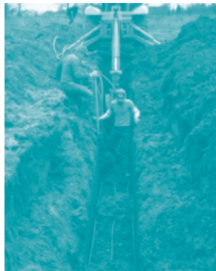
À l'aide d'une pelle rétrocaveuse, on creuse une tranchée destinée à l'installation d'une boucle souterraine.
